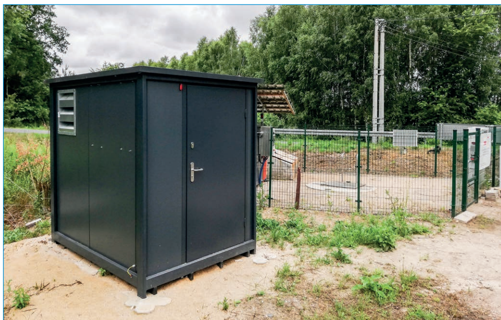
Fot. 1 | Kontener BTS obok przepompowni ścieków w m. Parowa
